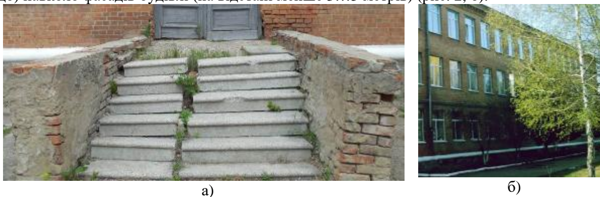
Рисунок 2 – Пошкодження зовнішніх сходів та зелені насадження навколо будівлі
