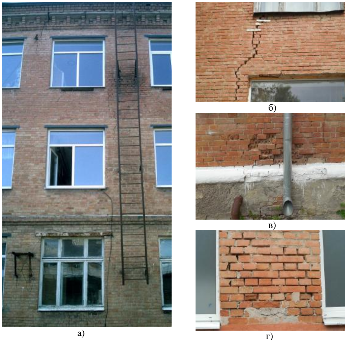
Рисунок 1 – Основні пошкодження цегляних стін
