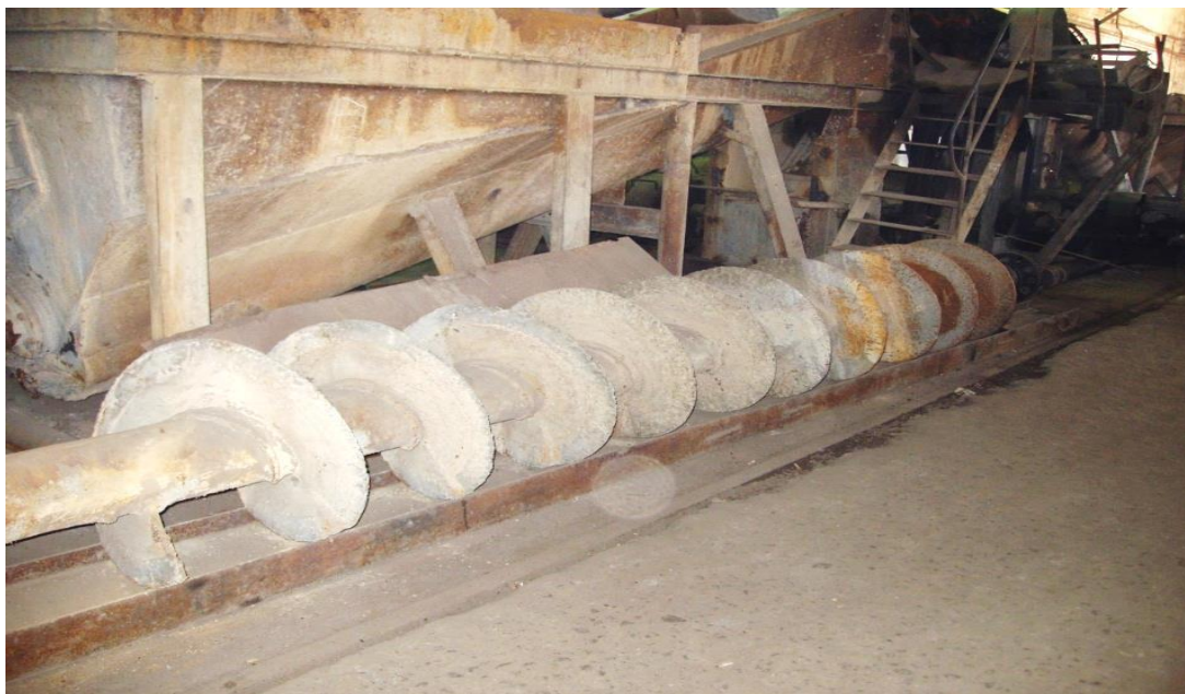
Рисунок 1 – Зовнішній вигляд відпрацьованого шнека шлакотранспортера системи шлаковидалення котлів ТЕЦ
