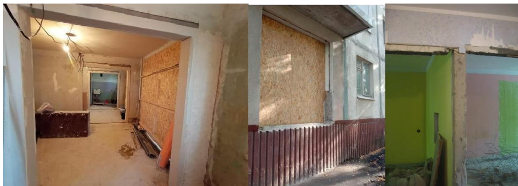
Рисунок 2. Самовільне влаштування прорізів в 5-ти поверховому панельному будинку
