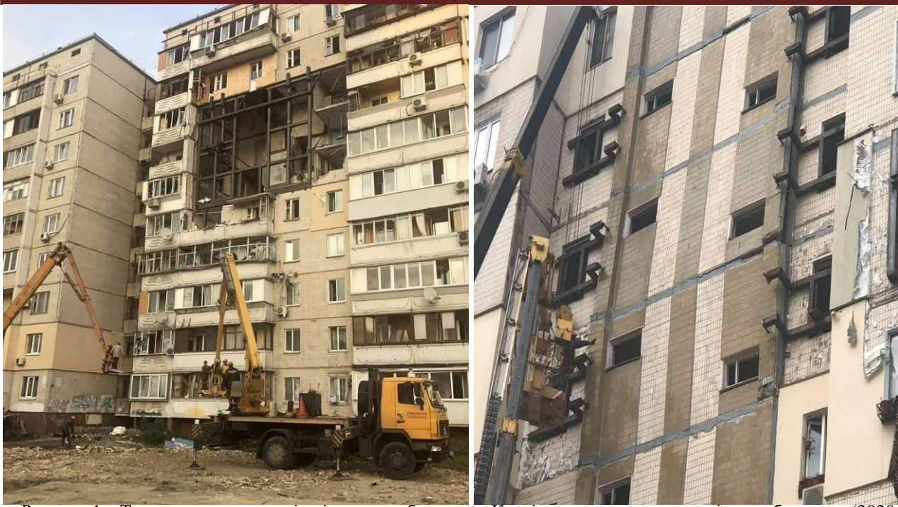
Рисунок 1 – Тимчасова конструкція підсилення будинку в Києві, пошкодженого внаслідок вибуху газу (2020 рік, [8])
